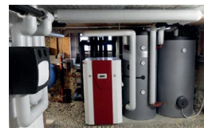
Für den Ersatz einer fossilen Heizung durch eine Sole-Wärmepumpe (Bild) spricht der Kanton Fördergelder.
